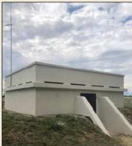
La station de pompage presque comme neuve. Photo DR
