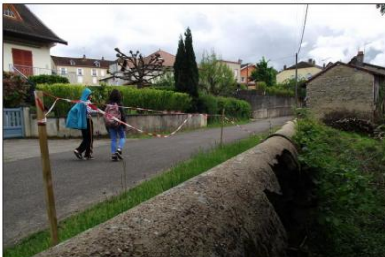
■ Rue Marchand, sur le chemin des écoliers, le mur qui s'écroule sera remplacé par un talus en pente douce. Photo Nicolas BROISSAND
